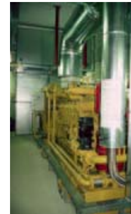
Decentral CHP module
